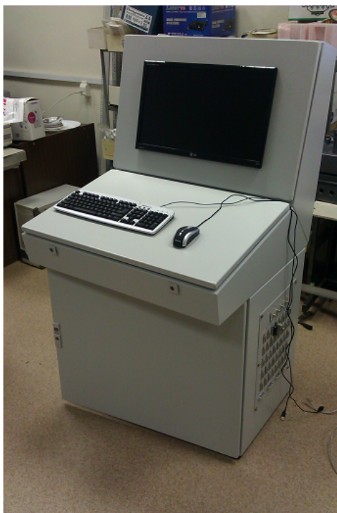
Рис. 6. Пульт управления установкой “Транзит-М”
